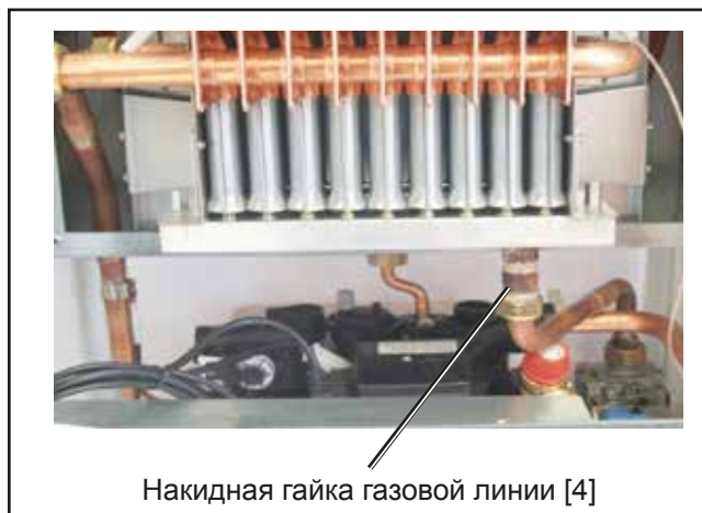
Рисунок: Очистка газовой горелки
